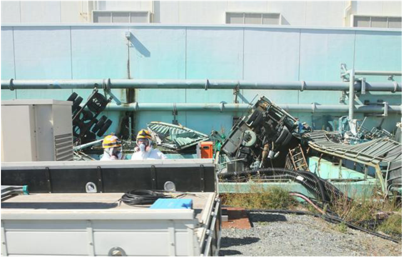
4号機タービン建屋の海側に残る津波で横転した車両＝10：41
