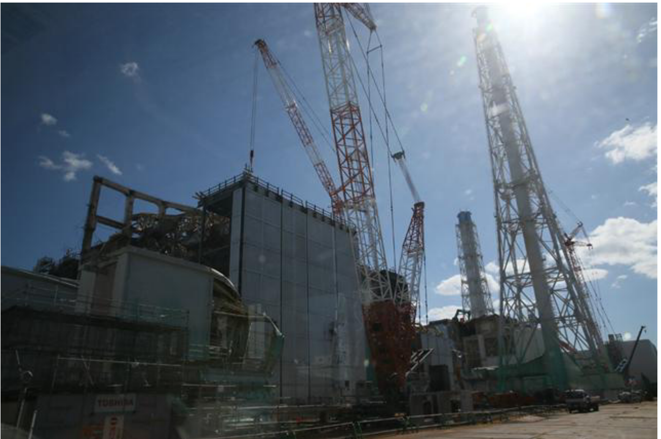
9月の鉄骨落下事故で、瓦礫撤去が中断している3号機（左）と4号機の原子炉建屋＝11：10
