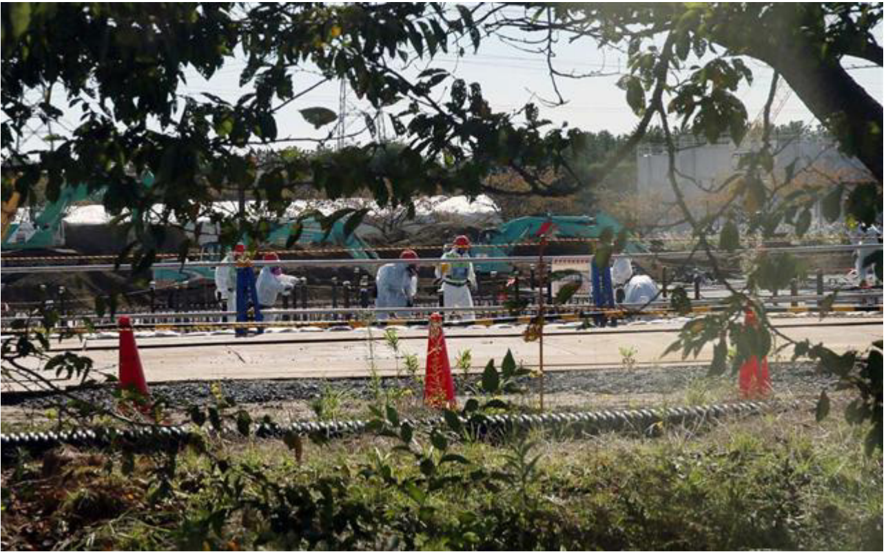
乾式キャスク仮保管庫の建設工事現場＝11：44 敷地内にある燃料保管の共用プールは近く満杯になる 空気で冷やす乾式の仮保管庫を建設し一部を移す計画で、基礎工事が始まった
