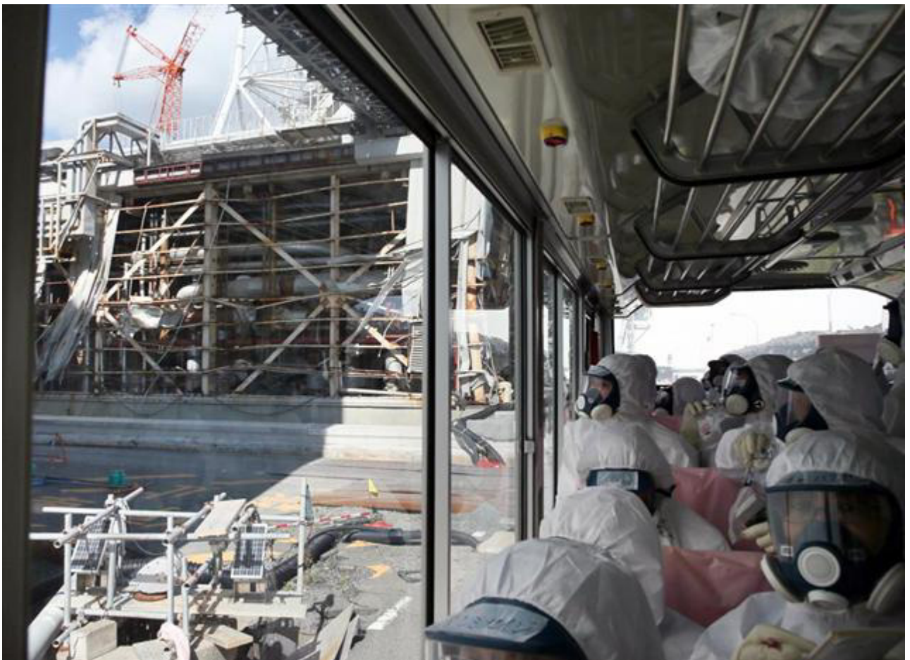
4号機の南側にある廃棄物処理建屋に残る津波の爪痕＝10：42
