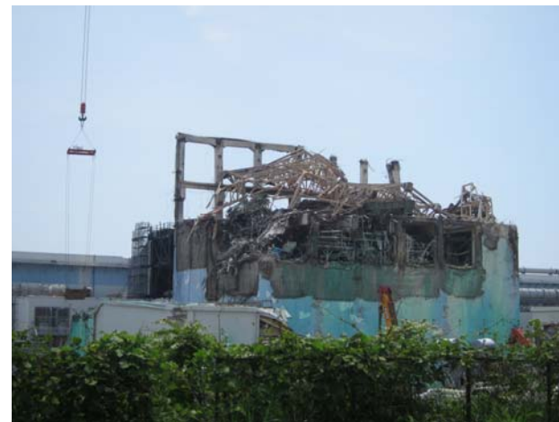
③-2 3号機原子炉建屋上部 平成24年6月18日 当社社員撮影
