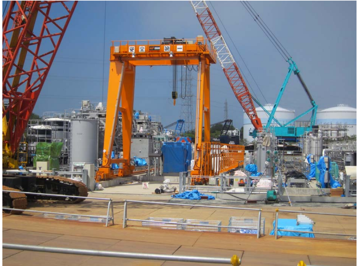
⑦-2 多核種除去設備建設現場 機器据付等 平成24年8月21日 当社社員撮影
