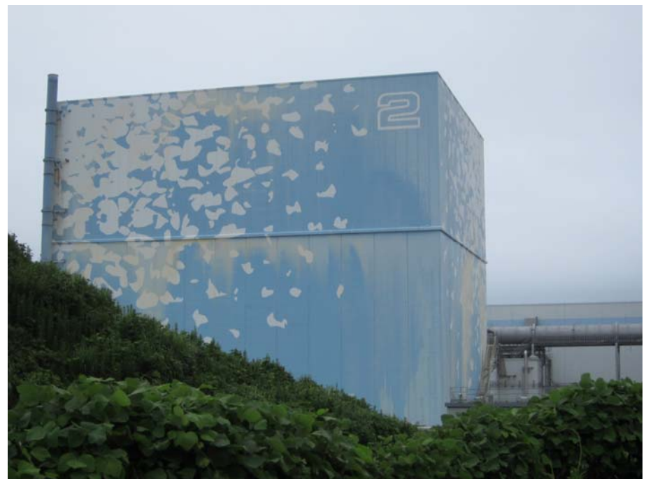
②-2 2号機外観 (2、3号機間山側高台より) 平成24年8月15日 当社社員撮影
