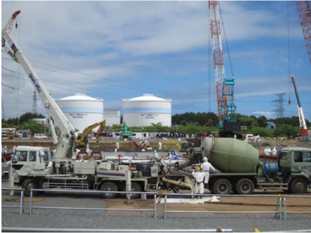
⑦-1 多核種除去設備建設現場 地盤改良工事 平成24年6月11日 当社社員撮影
