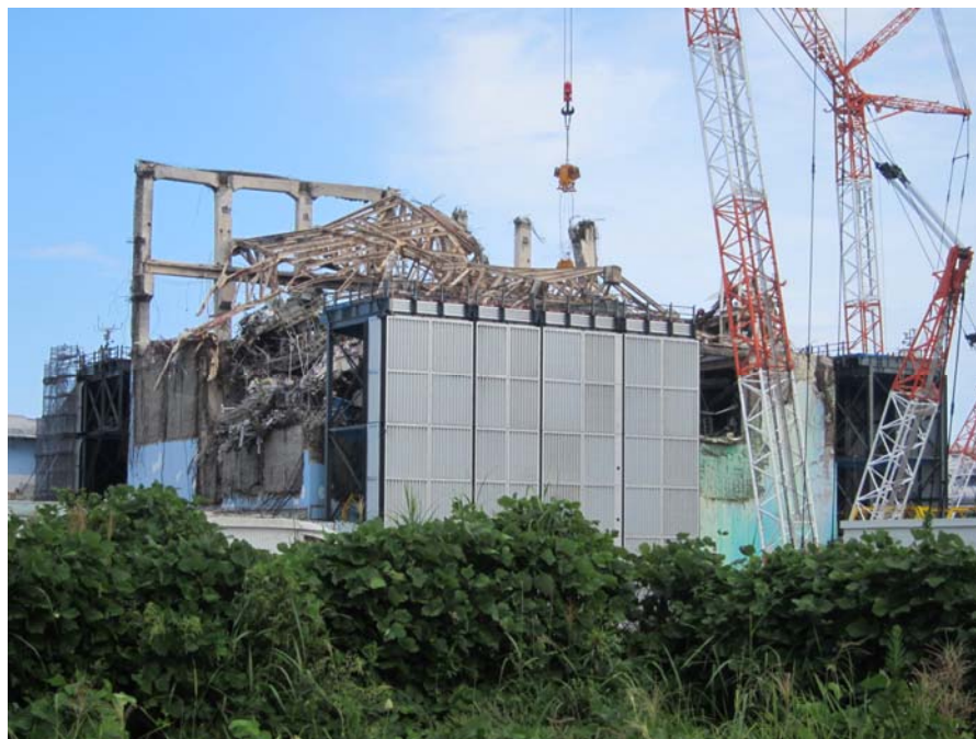
③-3 3号機原子炉建屋上部 平成24年9月5日 当社社員撮影
