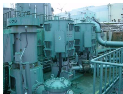
1号機格納容器冷却海水系ポンプ
