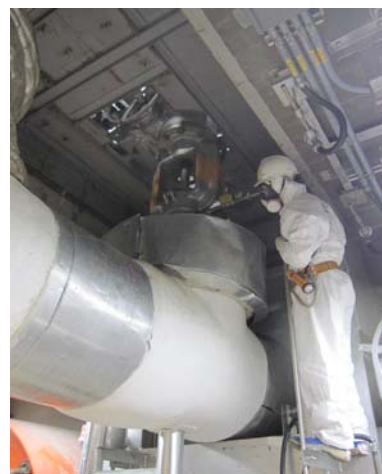
直径約 60cm の配管に設置されている RHR 注入弁 (5号機 照明あり)
