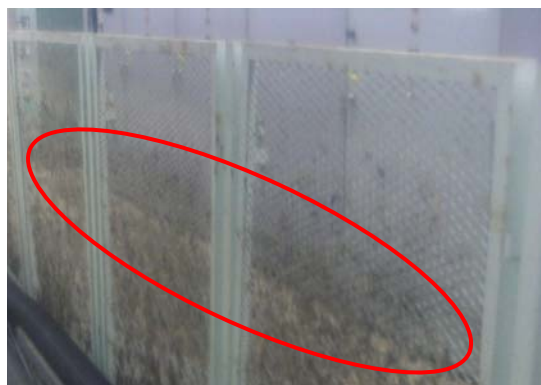
1号機タービン建屋1階 M/C の状況
