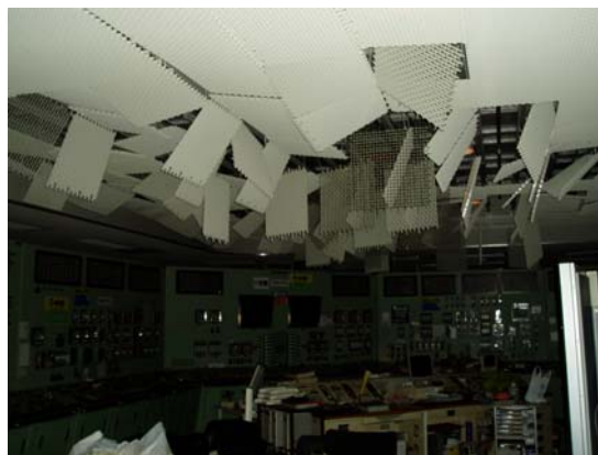
爆発後の中央制御室の状況
