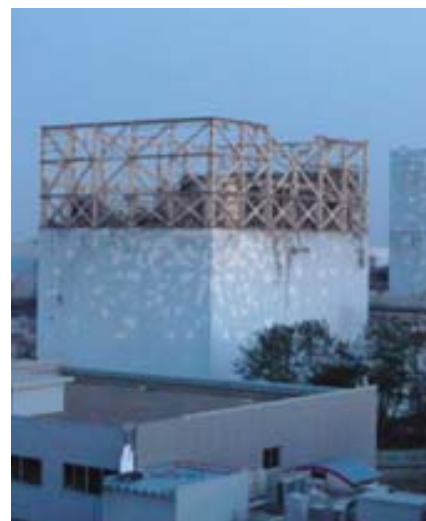
爆発後の1号機原子炉建屋
