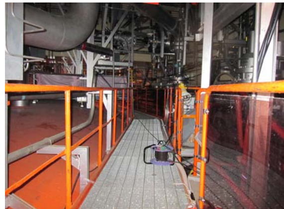
キャットウォーク (5号機, 照明あり)
