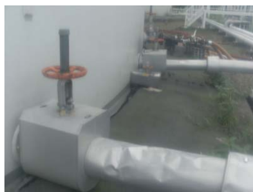
ろ過水タンク周りのタンク出口弁
