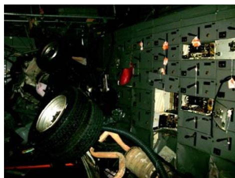
4号機大物搬入口の奥まで流されたトラック（後日撮影）
