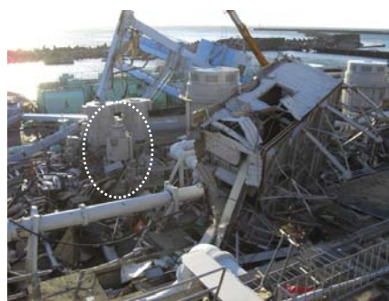
海水ポンプエリアの状況 (○内がDG(6A)海水ポンプ)
