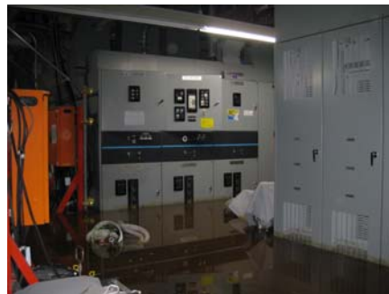
6号機電気品室の浸水状況
