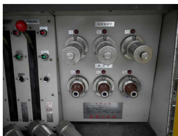
東北電力高压電源車。当社の高压電源車と同様に、P/C まで送電するためには仮設ケーブルの敷設及び端末処理が必要（後日撮影）
