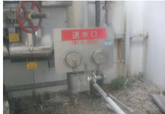
1号機消火系送水口
