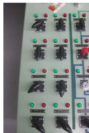
SRV 制御盤（後日撮影）
