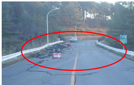
5,6号へのアクセス道路の損傷状況 (復旧後の状況。片側の道路の舗装をはいで、 碎石や砂利を流用して片側車線を復旧)
