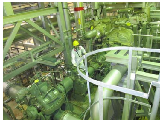
HPCI (5号機 照明あり)
