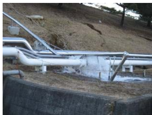
変圧器防災配管の漏えい
