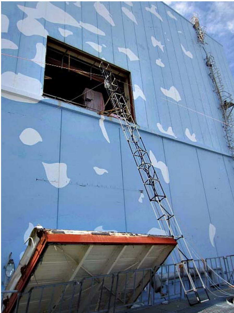
1F-2号機 開放されたままの排気口と落下したパネル (2011年8月29日撮影) = 東電提供
