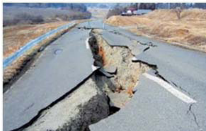
破損した農道 (岩手県奥州市)
