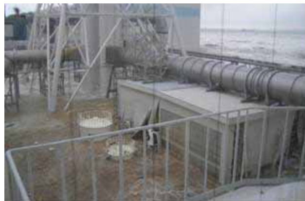
写真3. 福島第一原子力発電所 津波来襲状況 集中廃棄物処理建屋4階から北側を撮影 （平成23年3月11日撮影）
