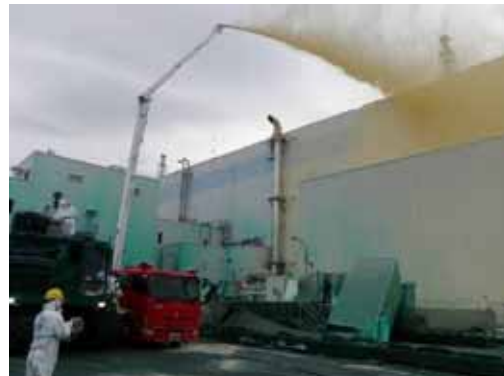
写真10. 1号機タービン建屋への飛散防止剤散布 （平成23年5月27日撮影）
