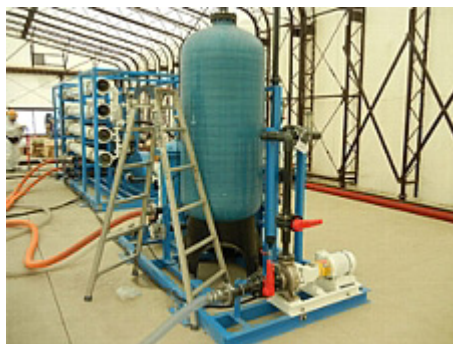
淡水化装置（ろ過装置）
