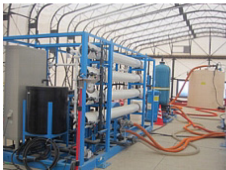
淡水化装置（RO モジュール）
