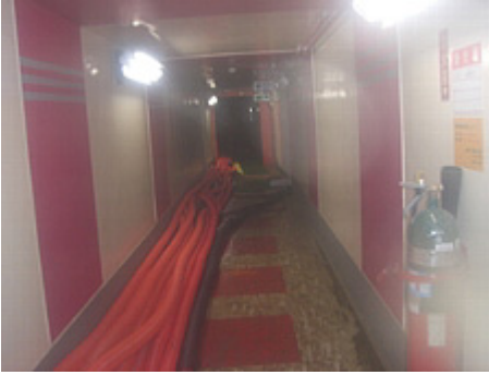
ホース設置状況（原子炉建屋から集中廃棄物処理施設）
