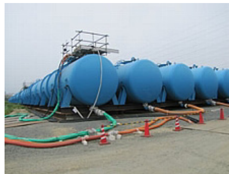
濃縮廃液用タンク
